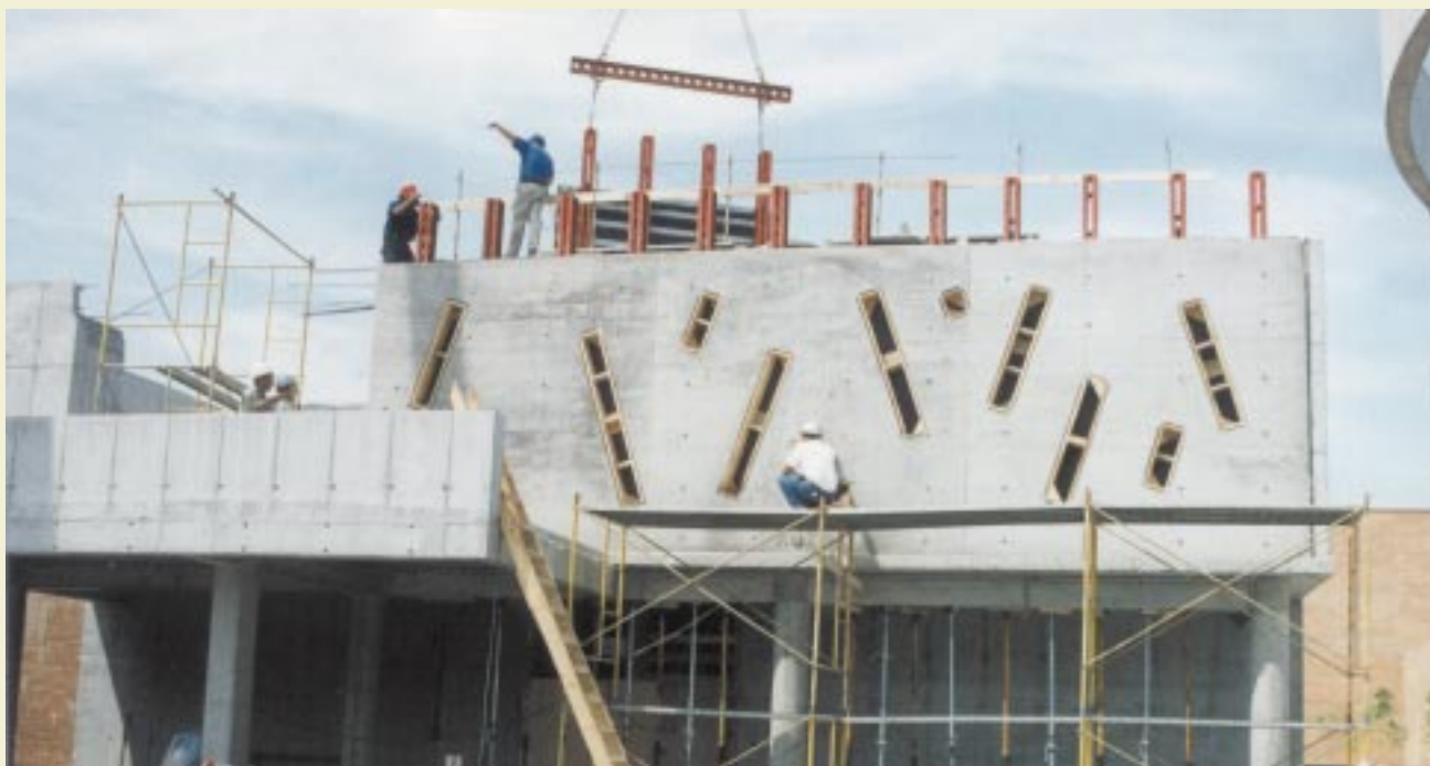
Vista de muro hormigonado con hormigón autocompactante bombeado desde la parte inferior, con una sola boca de entrada en el centro.
